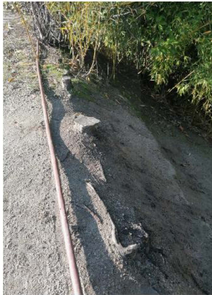
Talud Parque Europa
