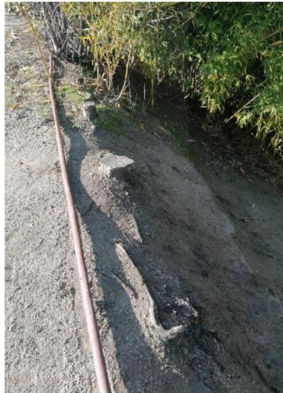
Talud Parque Europa
