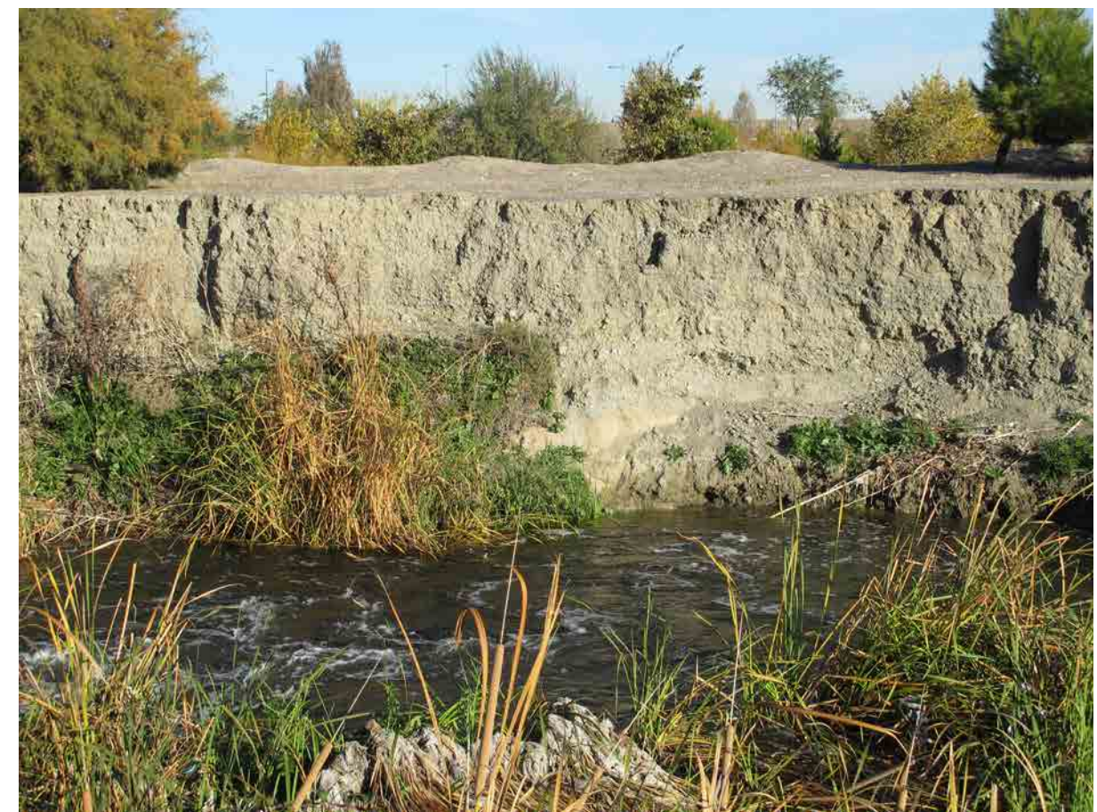
En algunos tramos, el cauce del arroyo Culebro está muy excavado, y presenta taludes de mucha altura y gran pendiente. A veces, se observan incluso algunos estratos que revelan antiguos vertidos de escombros.
