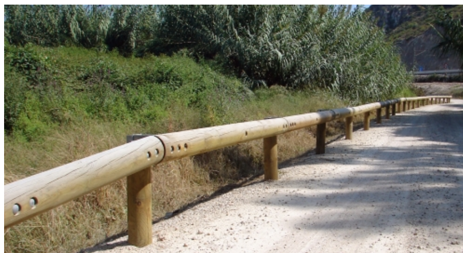
Ejemplo de bionda para delimitar el acceso.
